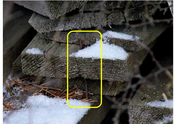
Abbildung 39: Gefahrenpotenzial durch anthropogene Hinterlassenschaften, hier ein aufragender Nagel in einem zerfallenen Hochsitz.
