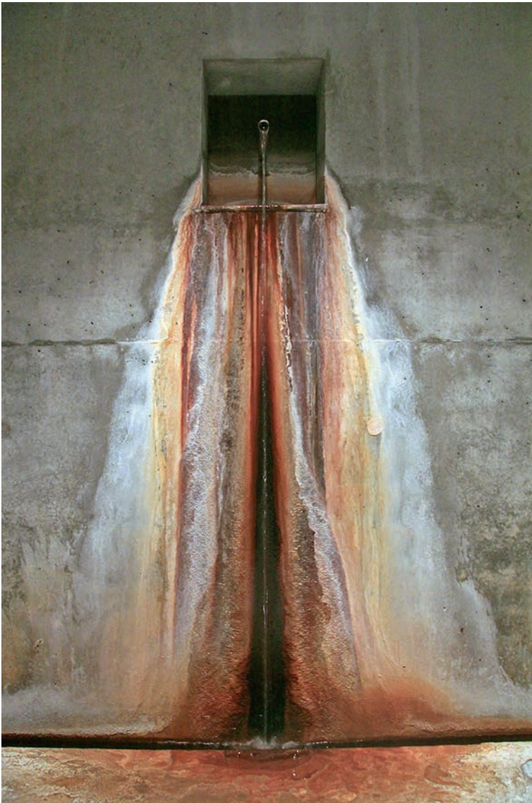
Abb. 5: Therme in Vals, Trinkhalle, Wasserspender mit Ablagerungen.
