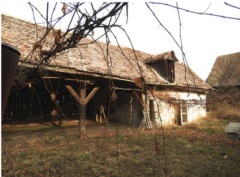
Abb. 9: Reichesdorf/Richiş Hausnr. 232. Schuppen und Wagenremise. Zustand vor der Renovierung. Aufnahme privat, 2017.
