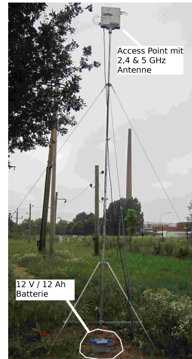
(b) Mobiler WLAN Access Point auf einem Mast mit seiner Batterie.
